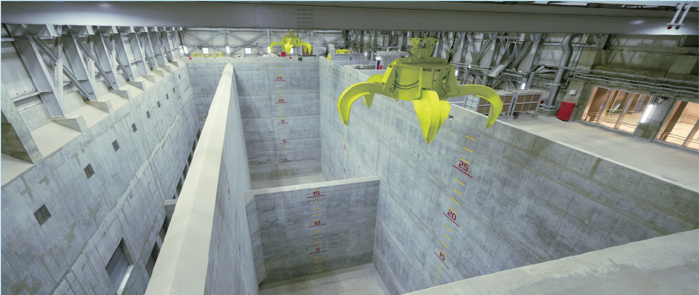
Hukay ng basura Ang basurang inilagay sa receiving pit ay inilipat sa stirring pit gamit ang crane ng basura, at ang basura ay hinahalo upang ito ay masunog ng mabuti. Ang kapasidad ng hukay ng basura ay 26,000 m 3 (katumbas ng mga 50 na 25 metro na swimming pool).
