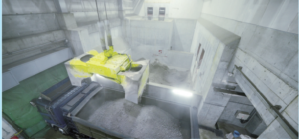
Ash pit and fly ash processing pit Ang abo sa ilalim ng incinerator na nabubuo pagkatapos magsunog ng basura sa isang incinerator at ang fly ash na nakolekta mula sa mga boiler, filter dust collectors, atbp. ay iniimbak dito.
