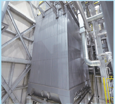
Filtration-type dust collector Naglalaman ito ng maraming cylindrical na filter na nakalinya na nagsasala ng exhaust gas na iniisprayan ng slaked lime at activated carbon, nag-aalis ng mga uling, alikabok at mga nakakapinsalang kemikal tulad ng sulfur oxide, hydrogen chloride, atbp.
