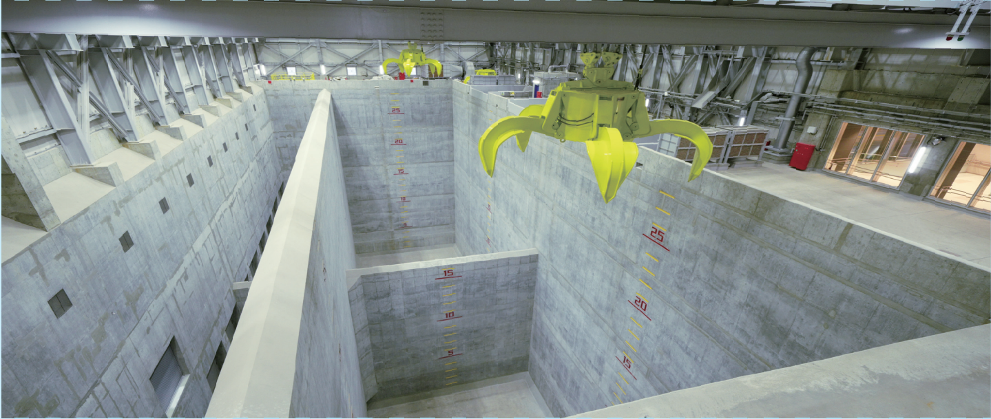
Hố rác Rác đưa vào hố tiếp nhận sẽ được chuyển đến hố trộn bằng cần cẩu rác, sau đó rác được trộn đều để cháy tốt hơn. Sức chứa của hố rác là 26.000 m 3 (tương đương khoảng 50 bể bơi 25 m).
