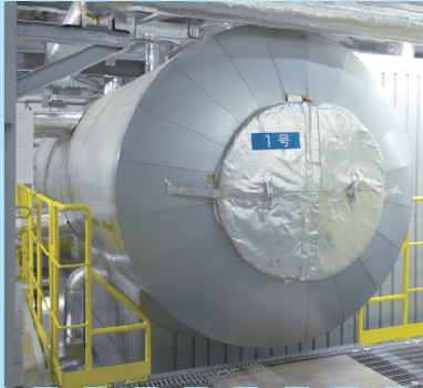
Caldera El calor de los gases de escape producidos por la incineración de residuos se utiliza para generar vapor a alta temperatura y alta presión, que se envía a la turbina.
