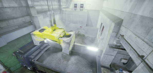
Fosa de cenizas y fosa de tratamiento de cenizas volantes Aquí se almacenan las cenizas del fondo del incinerador, generadas a partir de la combustión de residuos en el incinerador, y las cenizas volantes recogidas en la caldera y el colector de polvo de tipo filtración.
