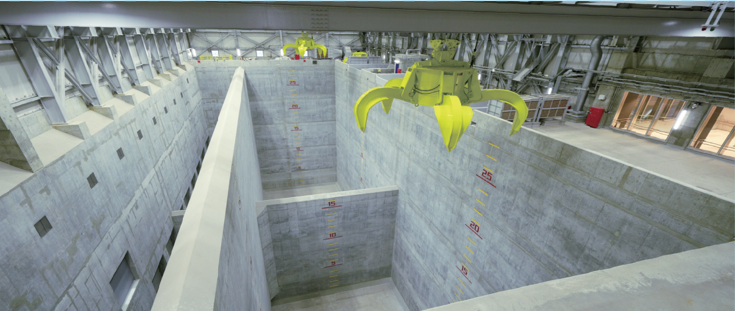
Fosa de residuos Los residuos vertidos en la fosa de recepción se trasladan mediante una grúa de residuos a la fosa de agitación, donde se agitan para que ardan bien. La capacidad de la fosa de residuos es de 26.000 m³ (equivalente a unas cincuenta piscinas de 25 metros).
