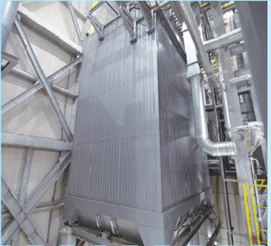
Colector de polvo de tipo filtración Este sistema utiliza hileras de filtros tubulares para filtrar los gases de escape tratados con cal apagada y carbón activado, eliminando sustancias nocivas como los óxidos de azufre y el cloruro de hidrógeno, así como el polvo.
