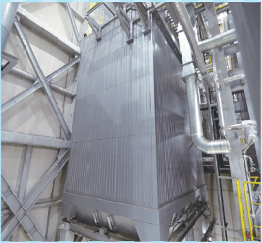
过滤式集尘器 排列着许多筒式过滤器，对吹入消石灰和活性炭的废气进行过滤，将煤尘与硫氧化物、氯化氢等有害物质一起去除。
