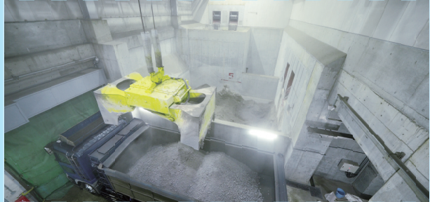
灰渣坑和飞灰处理物坑 将焚烧炉燃烧垃圾后产生的焚烧灰渣、以及锅炉和过滤式集尘器等收集的飞灰储存在这里。
