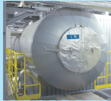
锅炉 利用垃圾焚烧产生废气的热量，产生高温高压蒸汽，送入蒸汽涡轮机。
