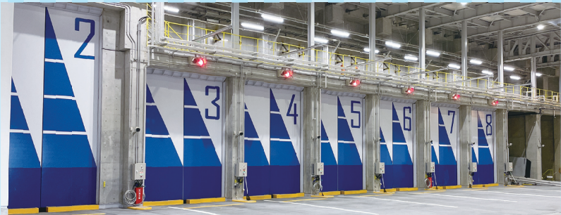
卸垃圾平台 垃圾收集车从8道投料门将称重后的垃圾投入垃圾坑中。为防止垃圾气味逸出，采用双重投料门和气压控制。
