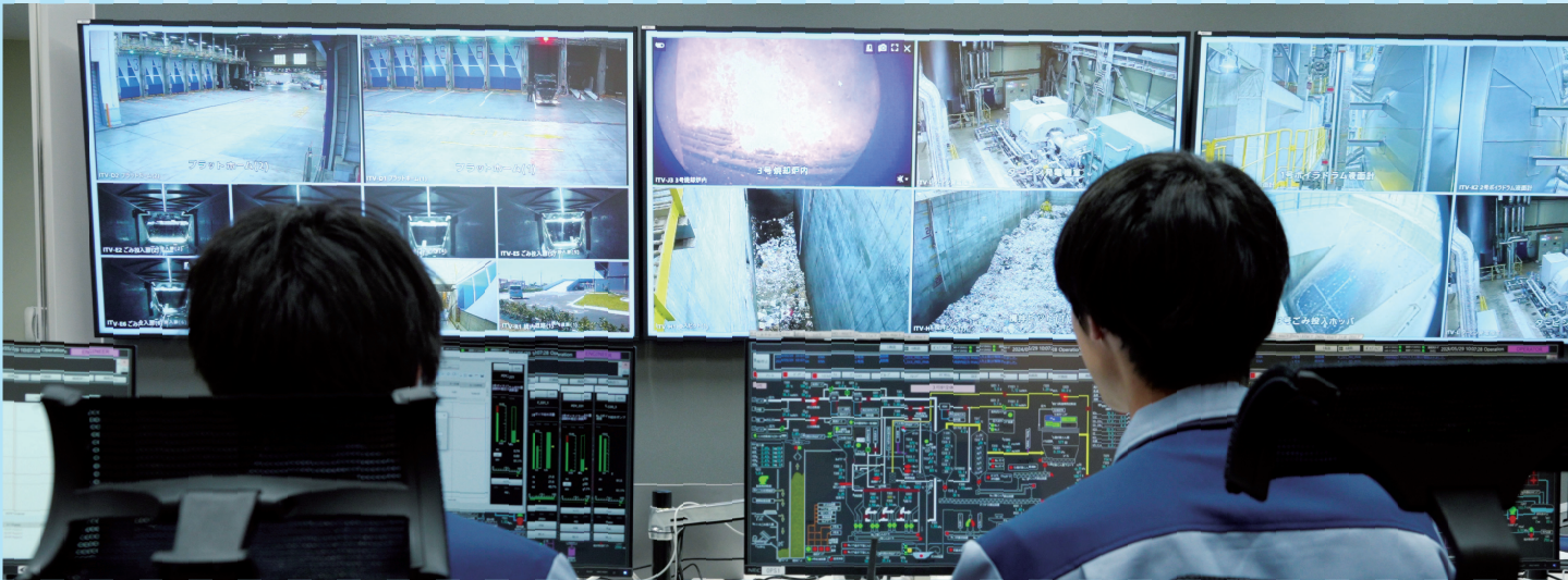
中央控制室 对整座设施的运行情况（焚烧炉内的温度和废气中的有害物质浓度等）进行监控和操作机器。同时还从设施外远程监控和远程操作，进行安心、安全、稳定的垃圾处理。
