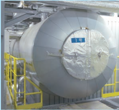
ボイラ ごみの焼却により発生する排ガスの熱を利用して高温・高圧の蒸気を発生させ、タービンに送ります。
