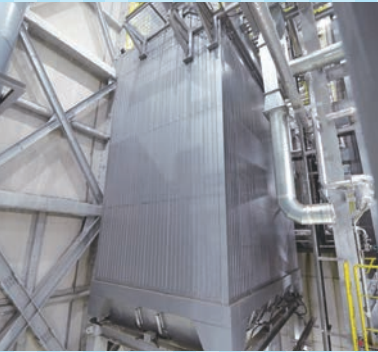
ろ過式集じん器 筒状のフィルタが多数並んでおり、消石灰と活性炭を吹き込んだ排ガスをろ過して、ばいじんとともに硫黄酸化物や塩化水素などの有害物質を除去します。
