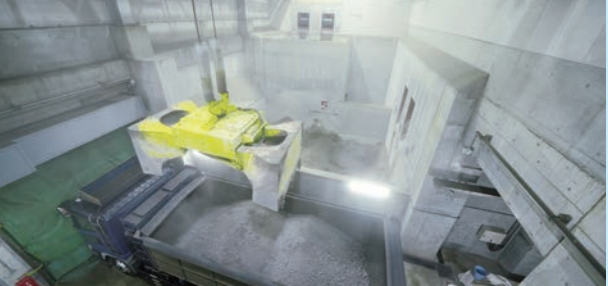
灰ピット・飛灰処理物ピット 焼却炉でごみを燃やした後に出る焼却灰と、ボイラやろ過式集じん器等から捕集した飛灰を貯留します。
