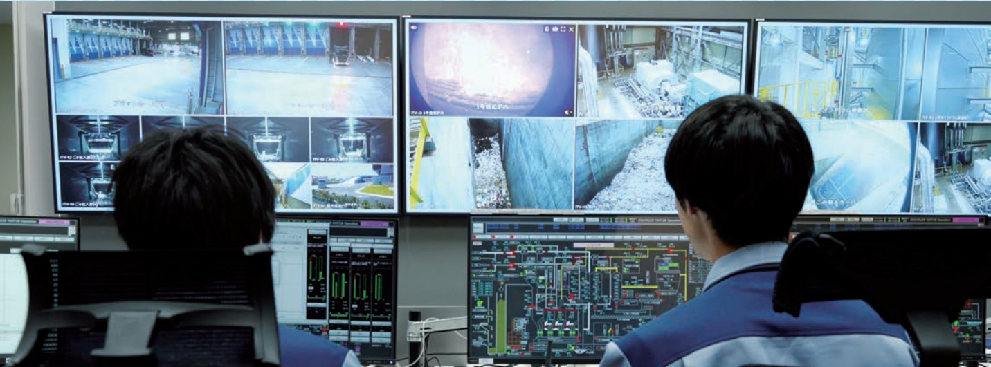
中央制御室 施設全体の運転状況（焼却炉内の温度や排ガス中の有害物質濃度など）の監視や機器の操作を行います。施設外からの遠隔監視・遠隔操作も併用し、安心・安全で安定的なごみ処理を行います。
