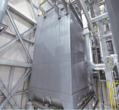
ろ過式集じん器 筒状のフィルタが多数並んでおり、消石灰と活性炭を吹き込んだ排ガスをろ過して、ばいじんとともに硫黄酸化物や塩化水素などの有害物質を除去します。
