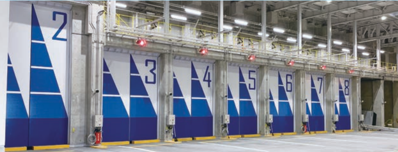
プラットフォーム ごみ収集車は計量後8つの投入扉からごみピットにごみを投入します。ごみの臭いを外に出さないように、投入扉の二重化や気圧制御を行っています。
