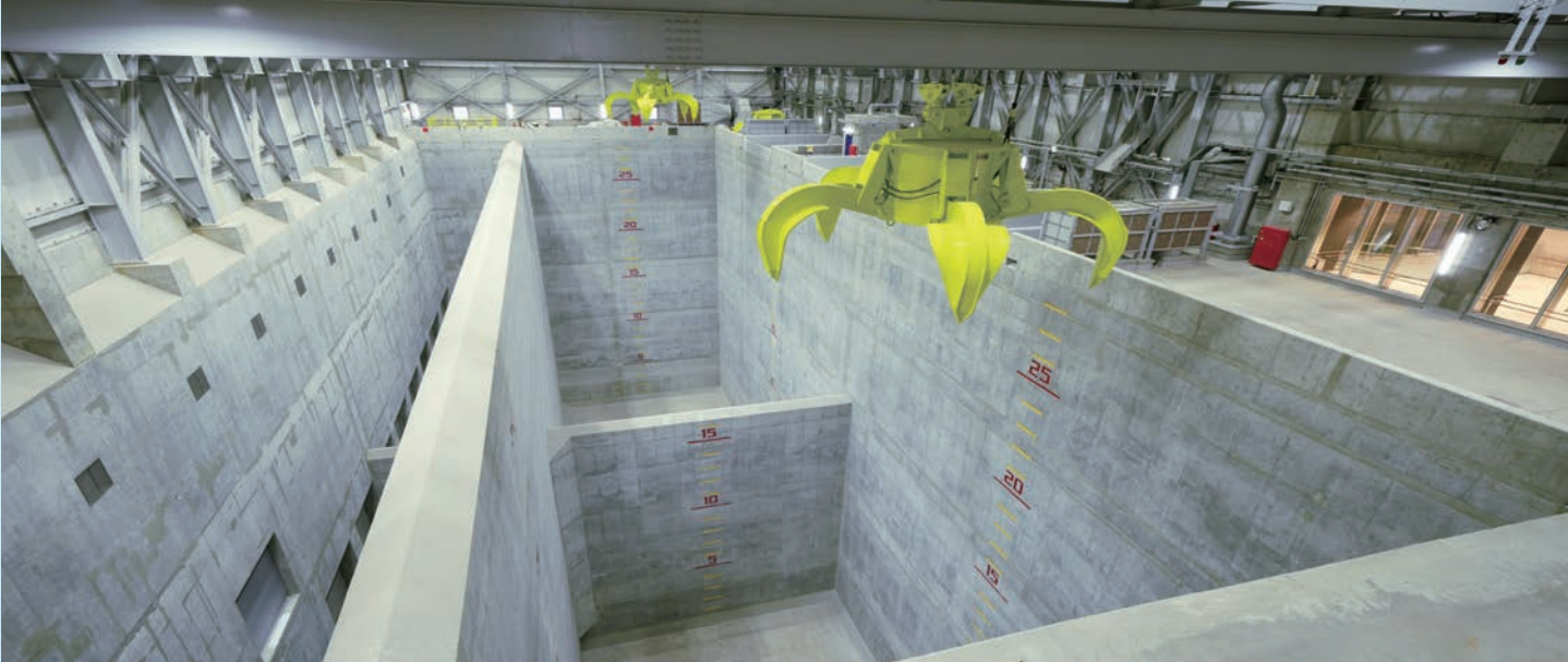
ごみピット 集められたごみは受入ピットに投入された後、ごみクレーンで攪拌ピットの中でごみがよく燃えるように攪拌されます。ごみピットの容量は26,000m 3 (25mプール約50杯分)です。
