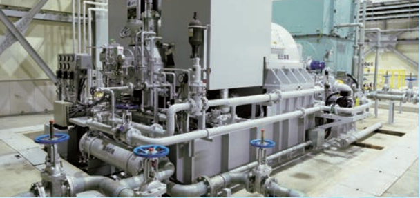
蒸気タービン発電機 ボイラから送られた高温・高圧の蒸気を利用してタービンを回し、高効率のごみ発電を行います。
