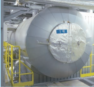
ボイラ ごみの焼却により発生する排ガスの熱を利用して高温・高圧の蒸気を発生させ、タービンに送ります。
